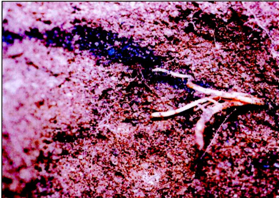
亀裂に注入された万補に伸びた根
