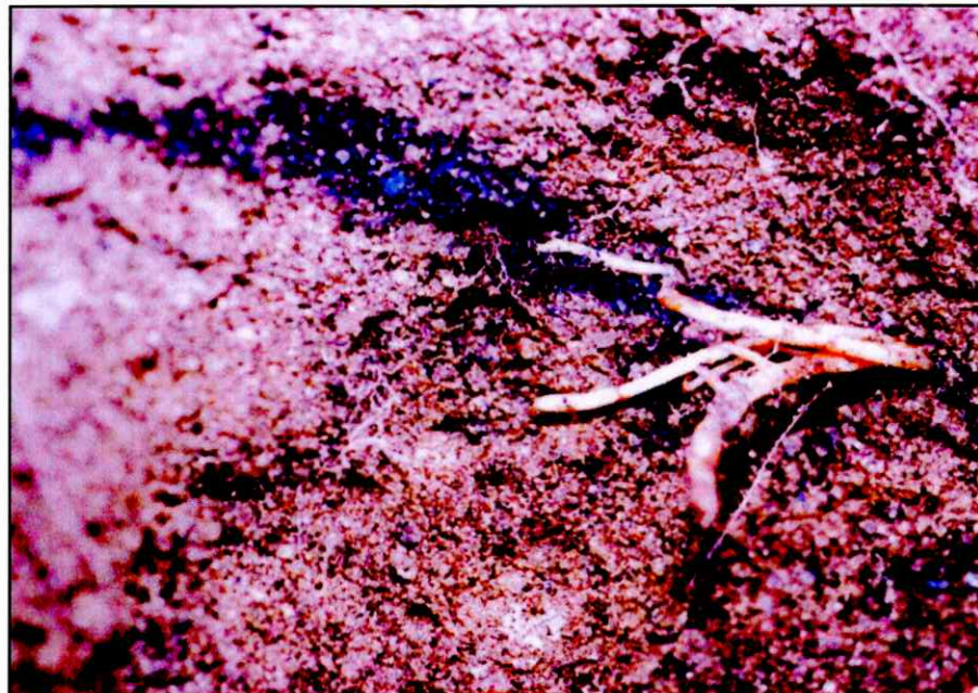
亀裂に注入された万補に伸びた根
